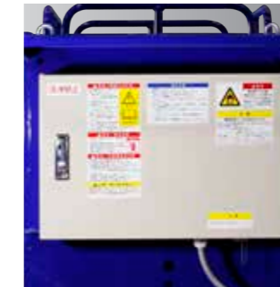
แผงควบคุมจะติดตั้งไว้บนชุดไฮดรอลิก
